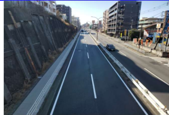
R6国道246号 有馬(2)電線共同溝工事 〔国土交通省 関東地方整備局 様〕
