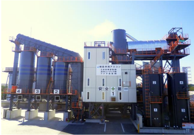
稼働燃料を重油から都市ガスへ変更 (Co2削減)
